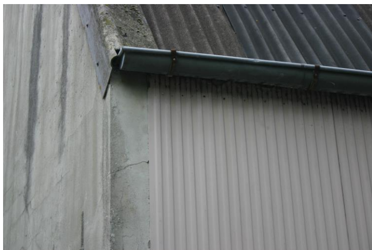
Figuur 4.4.3. De zijgevels van "Twinkeltje" zijn bedekt met stalen platen. Het dak is belegd met eternieten golfplaten.
