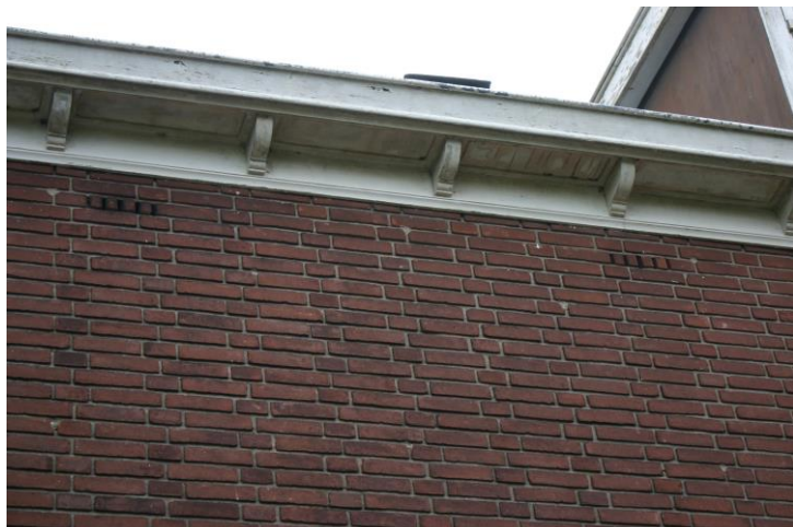
Figuur 4.4.2. Open stootvoegen in de zijgevels van nr. 43.
