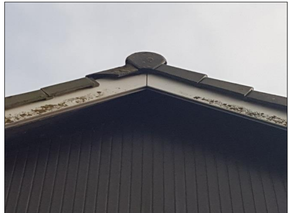
Figuur 14. Kapotte gevelpan aan westzijde woning
