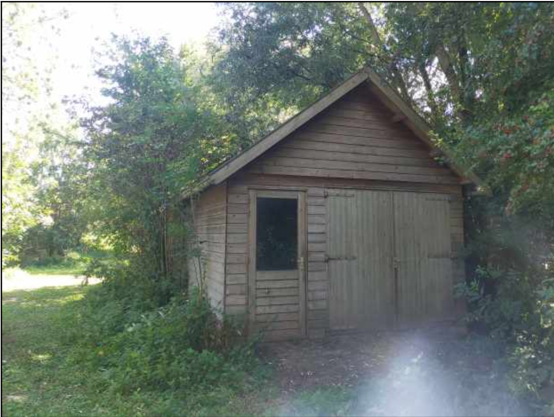
Afbeelding 10. Op het achterterrein aanwezige schuur welke wegens een gebrek aan dakpannen en invliegopeningen ongeschikt is voor gebouwbewonende vogelsoorten (Foto: M. van der Neut | Ecoresult B.V.).
